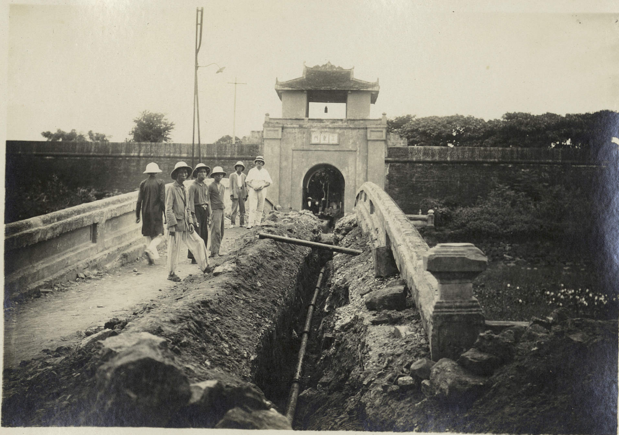
15 -POSE DE LA CONDUITE A L'ENTREE DE LA CITADELLE DE THANH-HOA ,BERCEAU DE LA FAMILLE IMPERIALE
